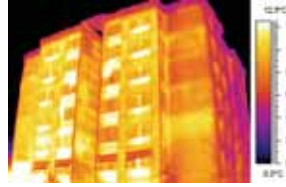
Yalıtımsız duvar ve pencere
