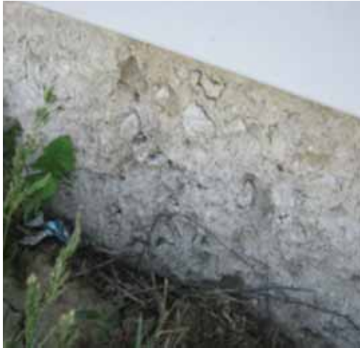
Şekil 1. Temelde donma çözülme hasarı
