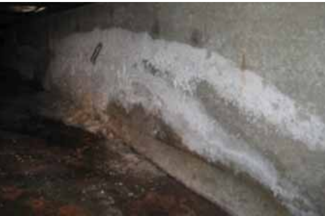
Şekil 5. Zemin altı bodrum perdesinde bir çiçeklenme ve hasar örneği
