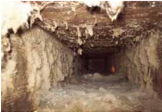
Resim 1: Bakımı yapılmamış bir havalandırma kanalı
