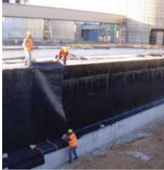
Şekil 4. Batıçım klinker stok holü perde su yalıtımı [görsel: www.emulzer.com.tr]
