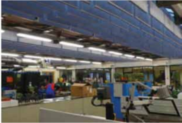
Şekil 5. Oda akustiğinin iyileştirilmesinde kullanılan ses yutucu elemanlarının tavana dizilişi
