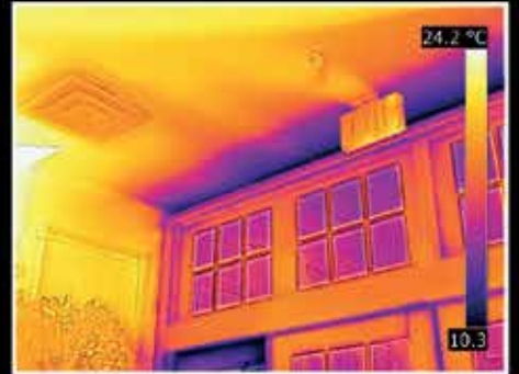
Yalıtım problemlerini tespit eder
