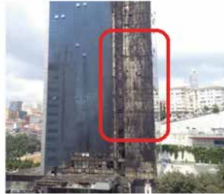
İstanbul'da bir binada giydirme cephede çıkan yangın
