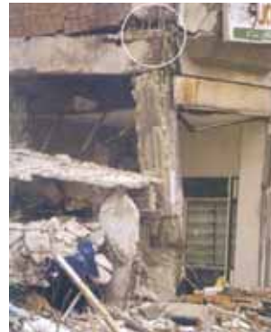
Şekil 1. 17 Ağustos 1999 Kocaeli Depremi'nde donatıların paslanarak kesitlerinin zayıflaması ve zamanla çürümesi sonucu yapıda ağır hasarların oluşması [4]
