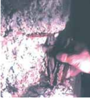
Şekil 2. Bodrum kat düşey donatılarının paslanması nedeniyle elle dağılabilmesi [4]
