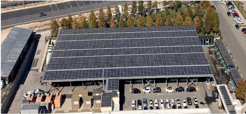
718 kW PV uygulaması
