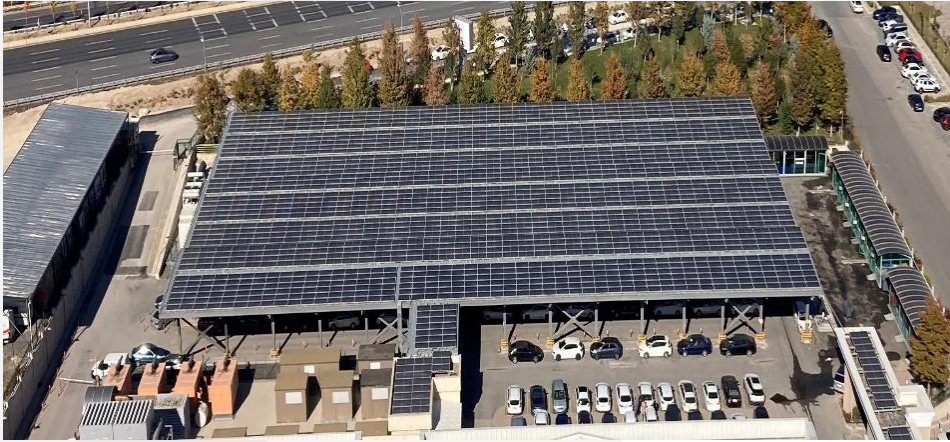
718 kW PV uygulaması
