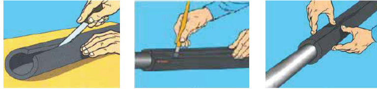
Şekil 46: Çapı 114 mm'nin altında olan mevcut tesisatlarda uygulamalar
