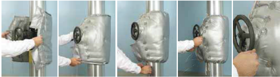
Şekil 70: Vana ceketleri ile yapılan uygulamalar
