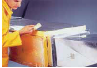
Şekil 63: Bir yüzü alüminyum folyo kaplı camyünü şiltelerle kanalların ısı yalıtımı
