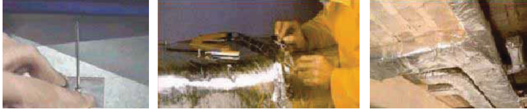
Şekil 62: Bir yüzü alüminyum folyo kaplı camyünü şiltelerle kanalların ısı yalıtımı
